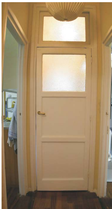
Puerta de acceso al aseo en el vestíbulo de cuartos húmedos en Hilarion Eslava, 2.
