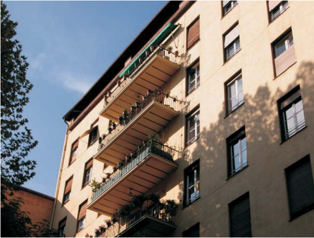
Barandillas en terraza de Hilarión Eslava, 2. Este modelo se repite en todas las terrazas a jardín y en Meléndez Valdés. MMN Arquitectos, Oct-2003
