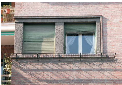
Arriba y abajo, ventana en esquina de Rodríguez San Pedro 72 c/v Gaztambide. Fotografías: MMN Arquitectos, Nov. 2003
