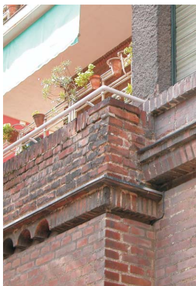
Detalle de fachada de ladrillo en Rodríguez San Pedro 70. MMN Arquitectos. Oct-2003.
