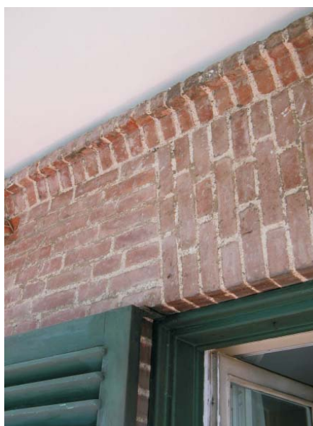
Detalle de encuentro de paramento vertical con techo de terraza. MMN Arquitectos, Oct-2003
