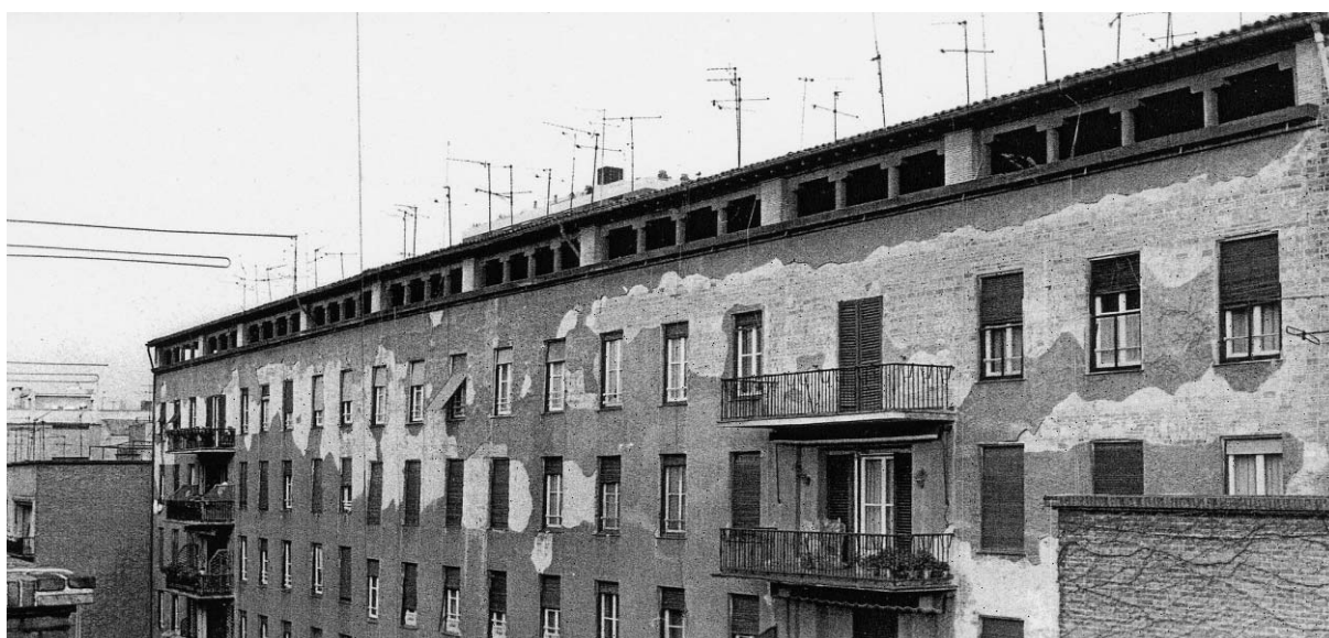
Fotografía de la fachada a jardín con el enfoscado perdido, realizada hacia 1971 por Pilar García Elorza y M. Teresa Gutiérrez Hevia. Servicio Histórico COAM. Se observa cómo la fábrica que asoma en las partes deterioradas parece ladrillo macizo en un aparejo distinto al de la fábrica vista.
