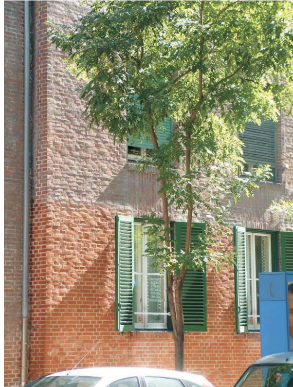
Fachada a calle Hilarion Eslava (núm.2). Obsérvese la vibración de la fachada ante la luz rasante y la diferencia de color en las partes que se han limpiado. MMN Arquitectos. Nov. 2003.
