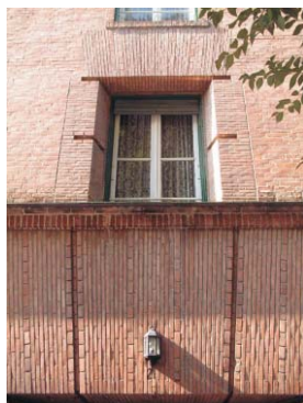
Ventana sobre portal Gaztambide 17, a haces interiores. La distribución interior es sin embargo la misma que el 2º. MMN Arquitectos, Nov. 2003
