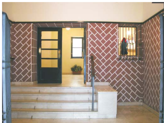
Portal de Rodríguez San Pedro, 70. MMN Arquitectos Nov. 2003 (el solado no es original)
