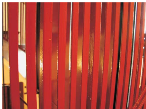
Se observa cómo hay tres pletinas intermedias entre barrotos cuadrados. Las pletinas son una adición tardía que restó ligereza a la caja de ascensor. Fotografías: MMN Arquitectos, Oct. 2003
