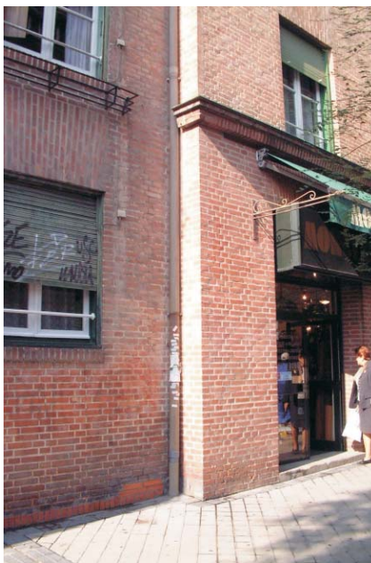
Bajante de pluviales en calle Gaztambide 19
