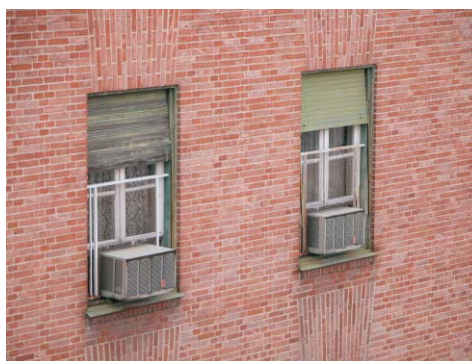
Equipo en fachada Rodríguez San Pedro 70.
