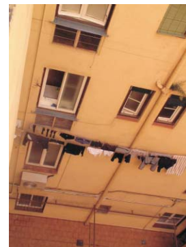
Equipo en fachada en Meléndez Valdés, 59. Fotografías: MMN Arquitectos, Oct. 2003
