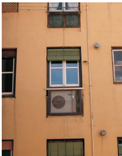
Las dimensiones del equipo han definido las dimensiones del hueco tras una reforma. Fotografías: MMN Arquitectos, Oct. 2003
