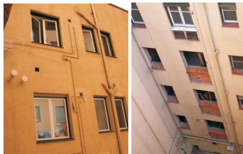
A la derecha dos intervenciones: En la foto superior se ha recreado el travesaño inferior de la ventana para permitir el paso de la encimera de cocina por delante, y el aparato de aire acondicionado se ha alojado en la fresquera. A falta de cubrir el hueco con la rejilla, se trata sin duda de una intervención más cuidadosa que las de las fotografías inferiores, de Gaiztambide 17 e Hilarion Esclava 4, donde se han eliminado directamente las fresqueras y con ello se ha cambiado el orden de la fachada.
