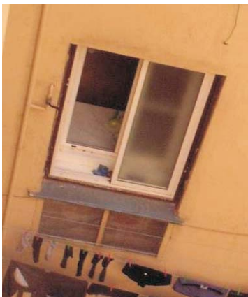
Ventana en Meléndez Valdés, 59. En esta sustitución además de añadir la doble ventana al interior se ha alterado el material y diseño de la ventana exterior original, vulgarizando el elemento.
