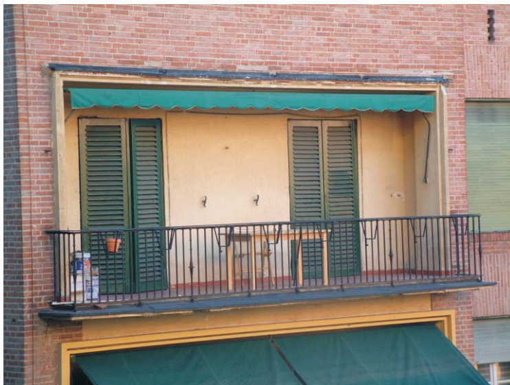
Rodríguez San Pedro a Jardín. Se han hecho reparaciones poco afortunadas en los salientes de fachada para solucionar problemas de estanqueidad.
