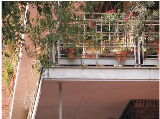
Restauración incorrecta de las bandejas de Rodríguez San Pedro 70. El mismo detalle que hemos visto en Meléndez Valdés 59. Fotografía: MMN Arquitectos, Oct. 2003
